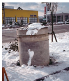
液状化現象によって浮き上がったマンホール (1998年釧路沖地震)
